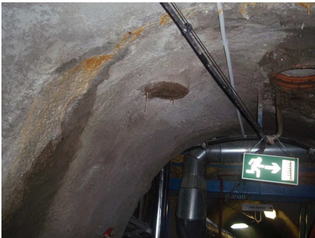
Obr. 4-2 Průsaky vody do kolektoru. (foto - Kopáček Pavel)
