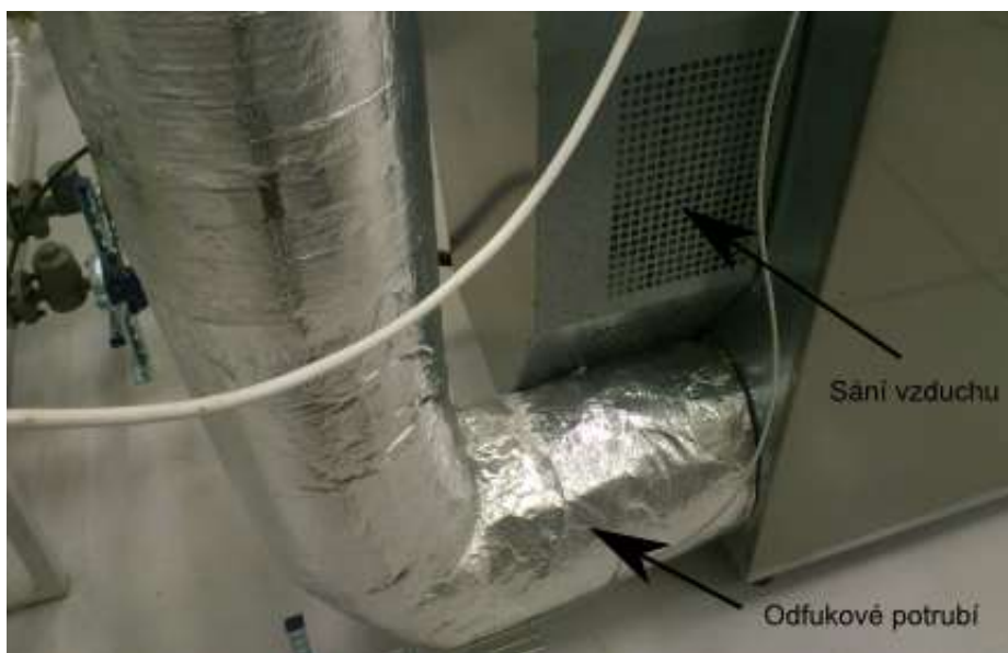
Obrázek 2-3 Přívod a odvod vzduchu
