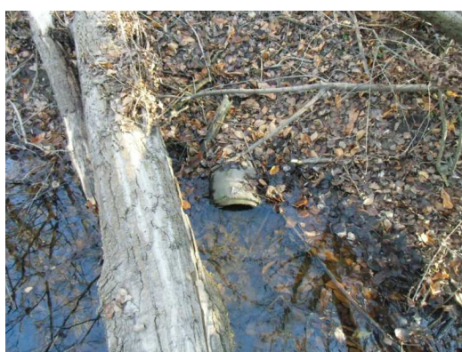
Zanesené výtokové potrubí
