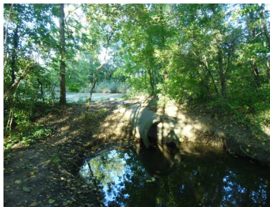
Zařízení nahrazující bezpečnostní přeliv
