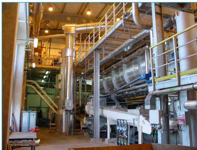
Obrázek 23: Sušárna kalu na ČOV Modřice [18]
