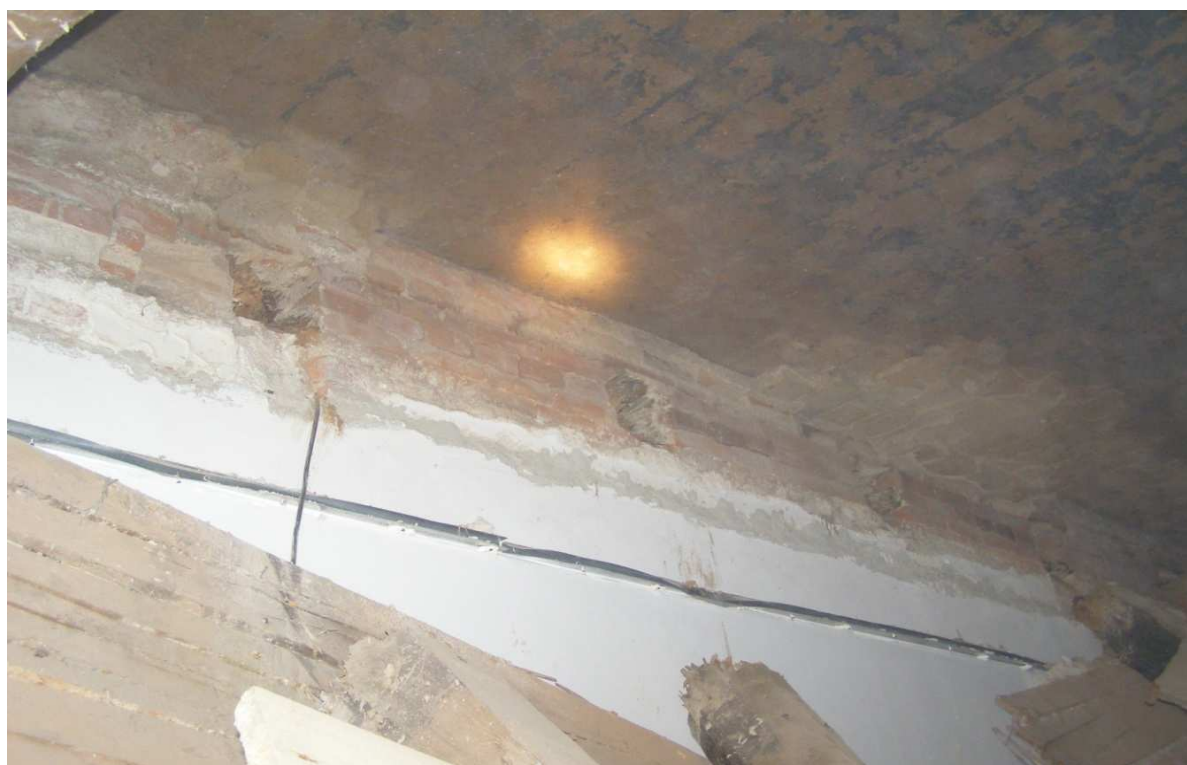
Obr.47 – Kolaps stávajícího dřevěného stropu
