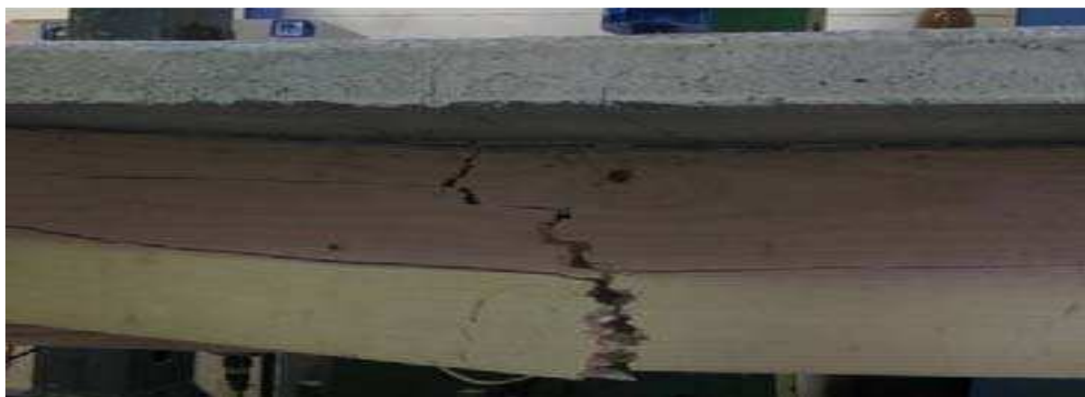
Obr.41 – Porušení nosníků tahovou trhlinou pod břemenem. [14]
