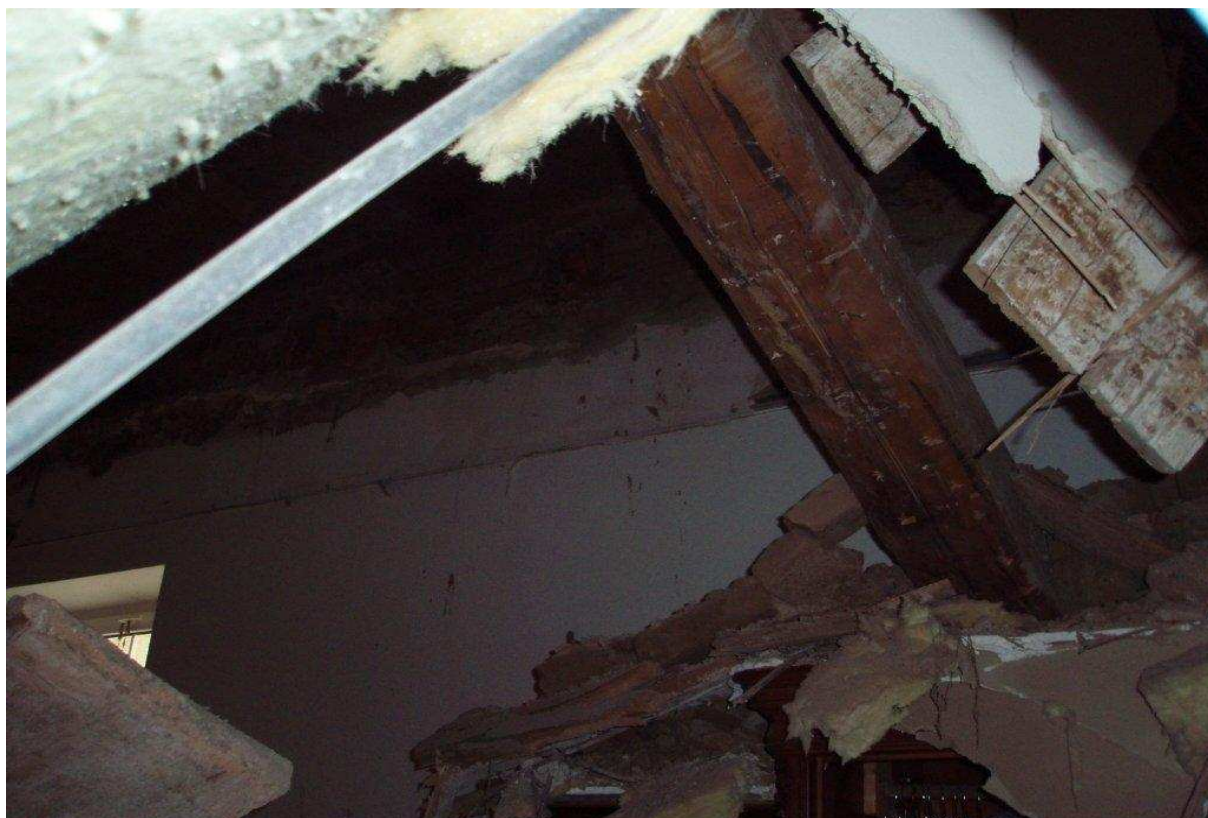
Obr.48 – Kolaps stávajícího dřevěného stropu
