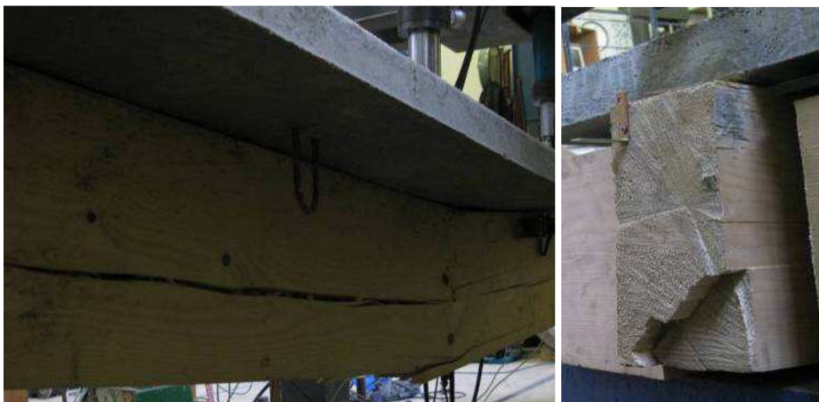
Obr.40 – Porušení nosníků podélnou smykovou trhlinou. [14]
