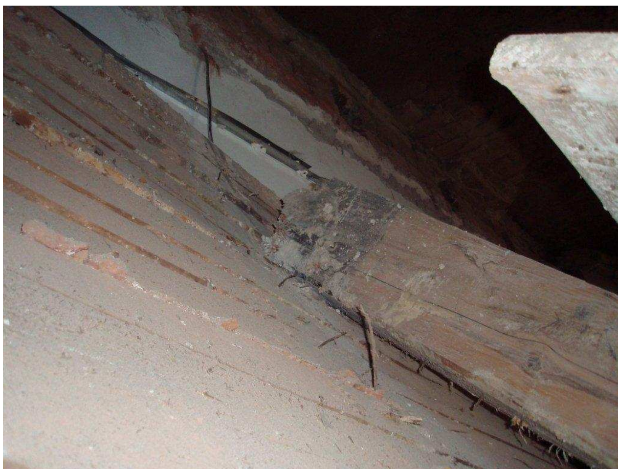
Obr.49 – Kolaps stávajícího dřevěného stropu
