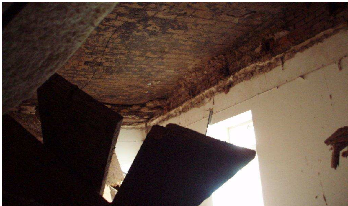
Obr.46 – Kolaps stávajícího dřevěného stropu
