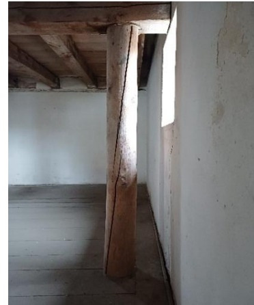
Obrázek 7 - Sloup ve 2. NP bez sedla (průvlak není uložen do zdi)
