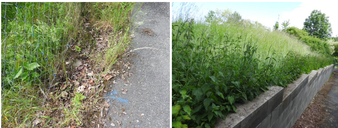
Obrázek 71 Vlevo zanesený betonový žlab kolem plotu, vpravo náletové křoviny, vysoká tráva a rostliny na a kolem AN
