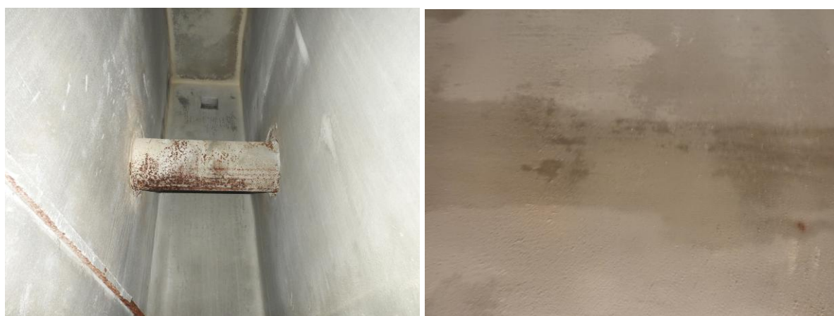
Obrázek 60 Vlevo, průchod potrubí bezpečnostního přelivu z AN č.1 do AN č.2 a odvětrání, vpravo fleky vody po průsaku
