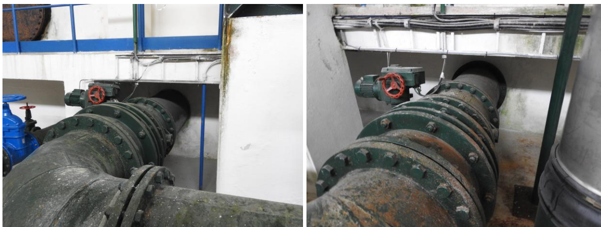
Obrázek 42 Vlevo potrubí z AN č. 1 s uzávěrem vybaveným servo pohonem DN 600 a montážní vložkou DN 600, vpravo potrubí z AN č. 2 s uzávěrem vybaveným servo pohonem DN 600 a montážní vložkou DN 600
