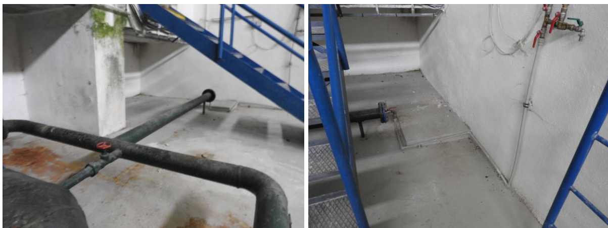
Obrázek 48 Vlevo potrubí DN 100 z odpadního potrubí AN č.2, vpravo napojení odpadního potrubí na vodočetnou lať
