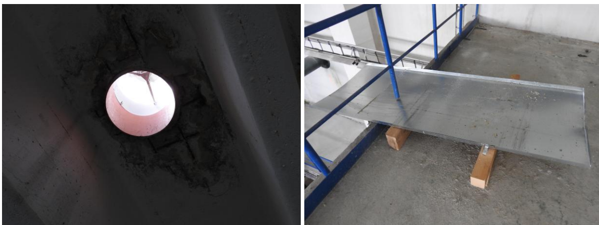
Obrázek 55 Vlevo prostup ventilační turbíny a obnažená výztuž, vpravo plech pro zachytávání kapek vody
