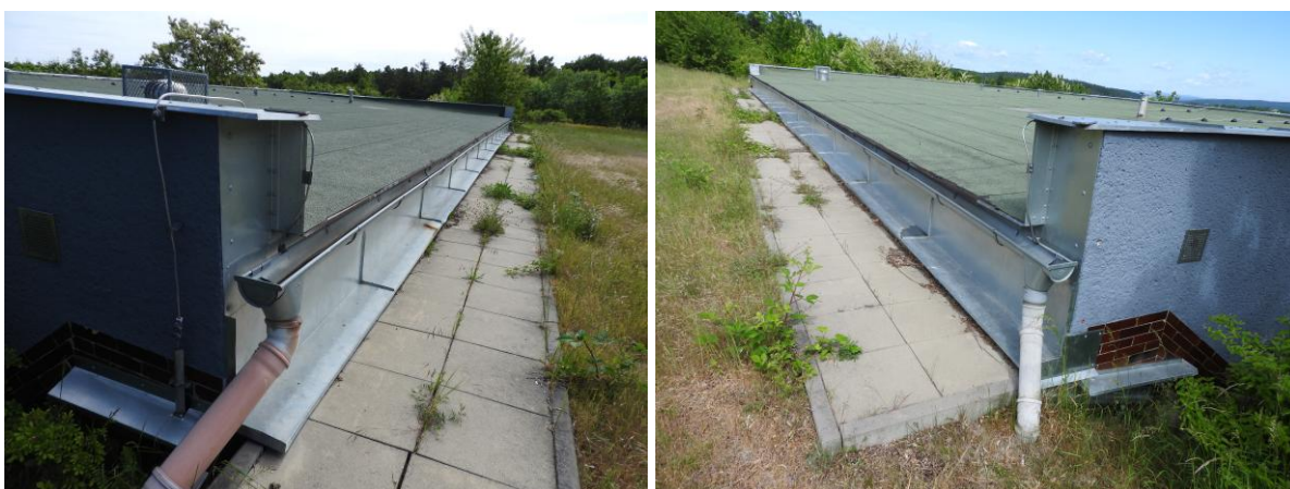
Obrázek 63 Vlevo okapový žlab vypouštěný do betonového žlabu, vpravo okapový žlab vypouštěný do kanalizace
