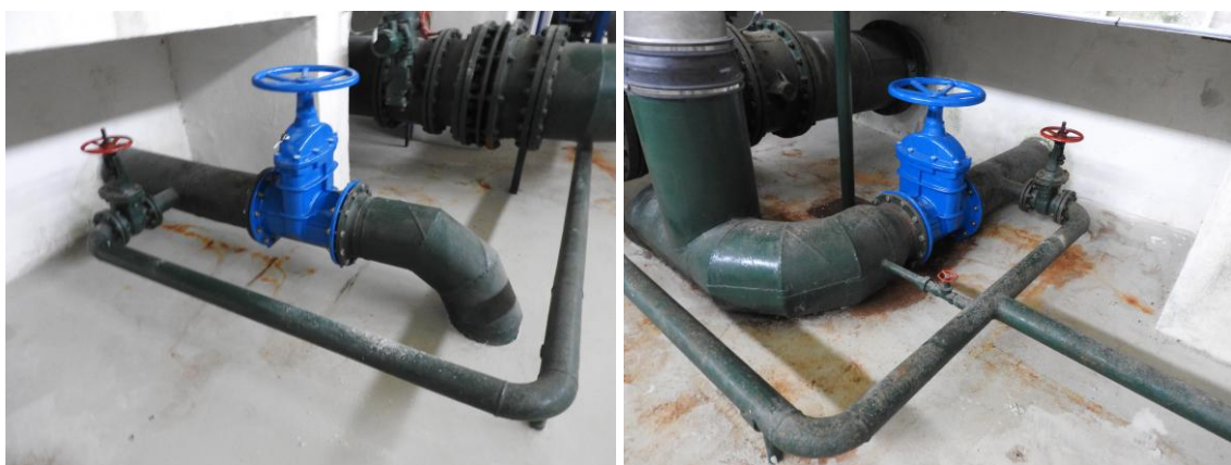
Obrázek 47 Vlevo odpadní potrubí z AN č.1 s šoupětem DN 300 a napojené potrubí DN 100, vpravo odpadní potrubí z AN č.2 s šoupětem DN 300 a napojené potrubí DN 100
