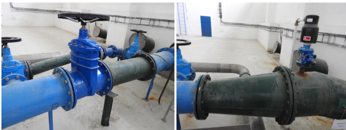
Obrázek 45 Šoupě DN 300 na hlavní větvi mezi obtokem, vpravo redukce 500/300, šoupě a vzdušník
