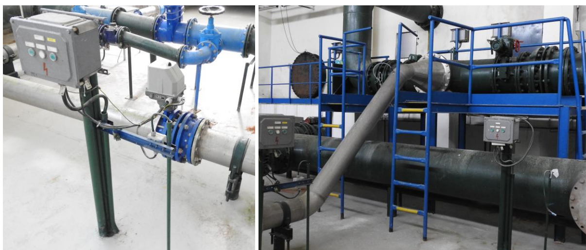
Obrázek 39 Uzávěr se servopohonem DN 250 a montážní vložka DN 250, vpravo šikmé potrubí a ocelová plošina
