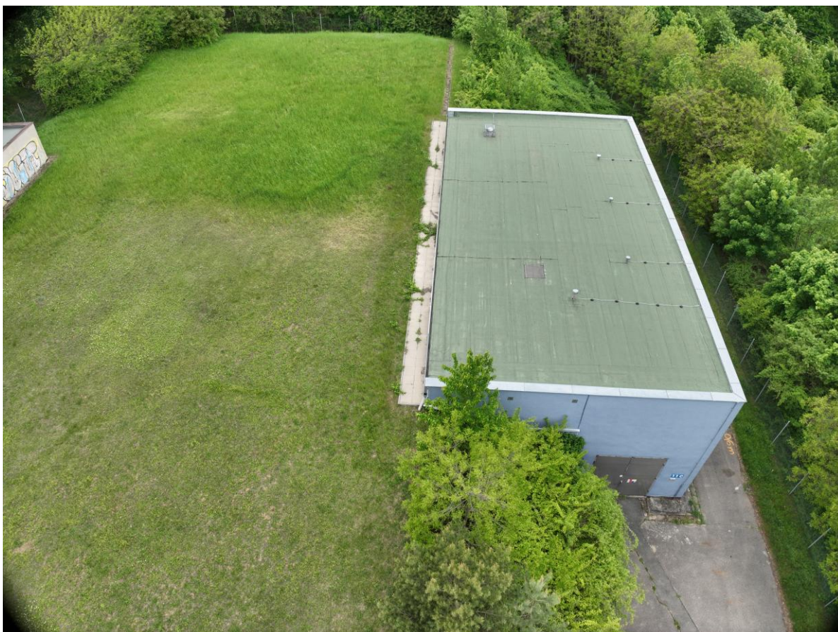
Obrázek 64 Snímek z dronu, který zachycuje prostor střechy s ventilační turbínou, dalším odvzdušněním armaturní komory, hromosvodem a odvodňovací betonový žlab
