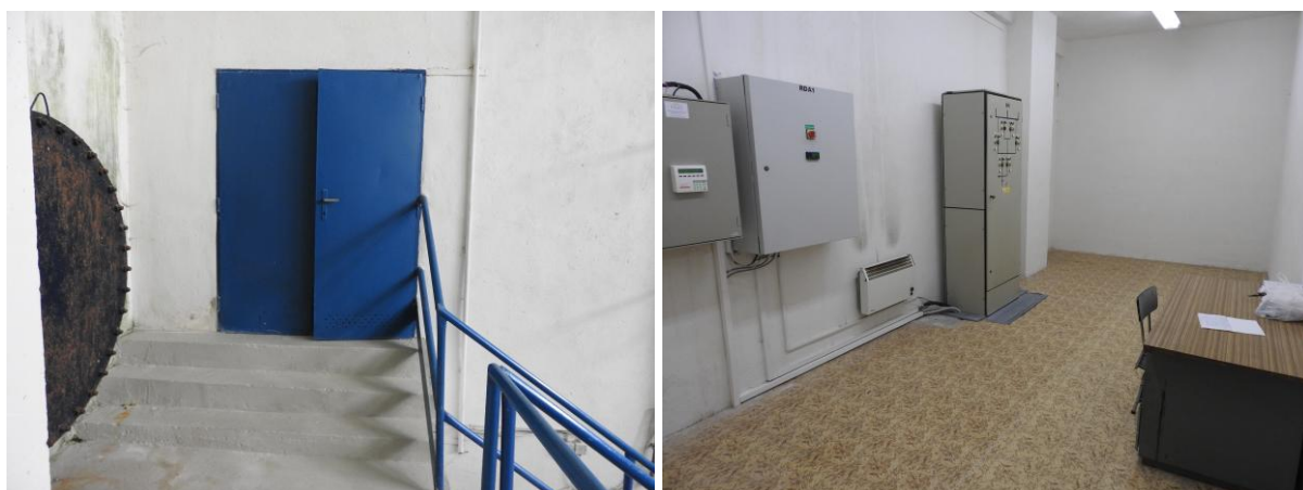
Obrázek 52 Vlevo dvoukřídlové dveře rozvodny, vpravo prostor a vybavení rozvodny
