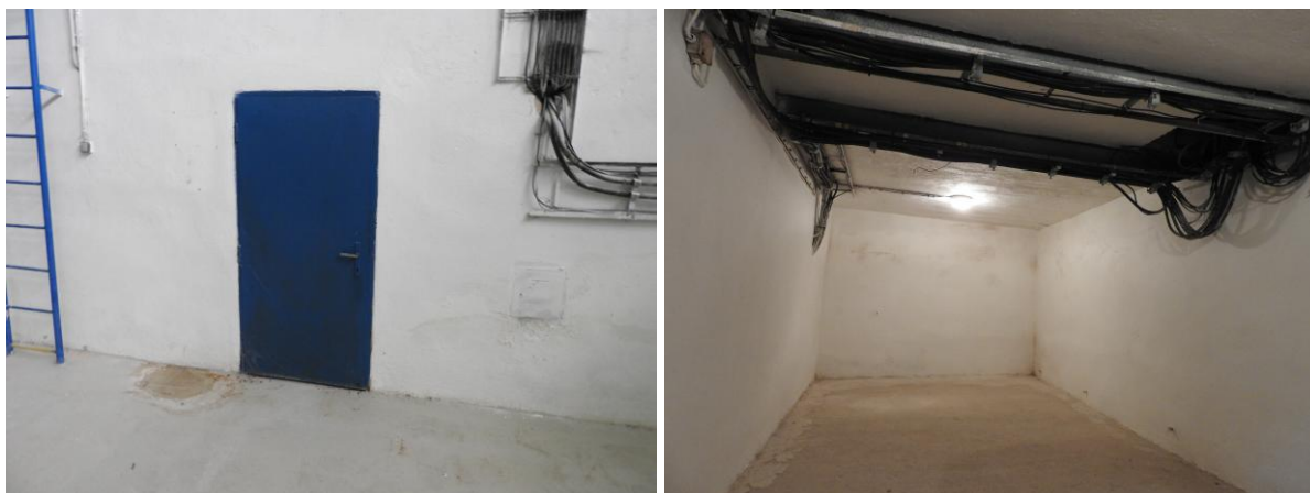
Obrázek 51 Vlevo jednokřídlové dveře pro vstup do technické místnosti, vpravo prostor technické místnosti
