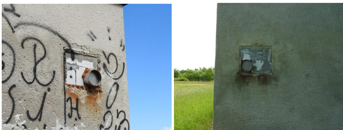
Obrázek 66 Vlevo odvědušnění AN č.1, vpravo odvědušnění AN č.2
