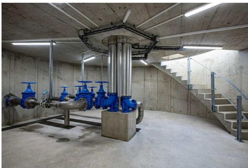
Obrázek 2 Podzemní armaturní komora věžového vodojemu Ohrazenice [6]
