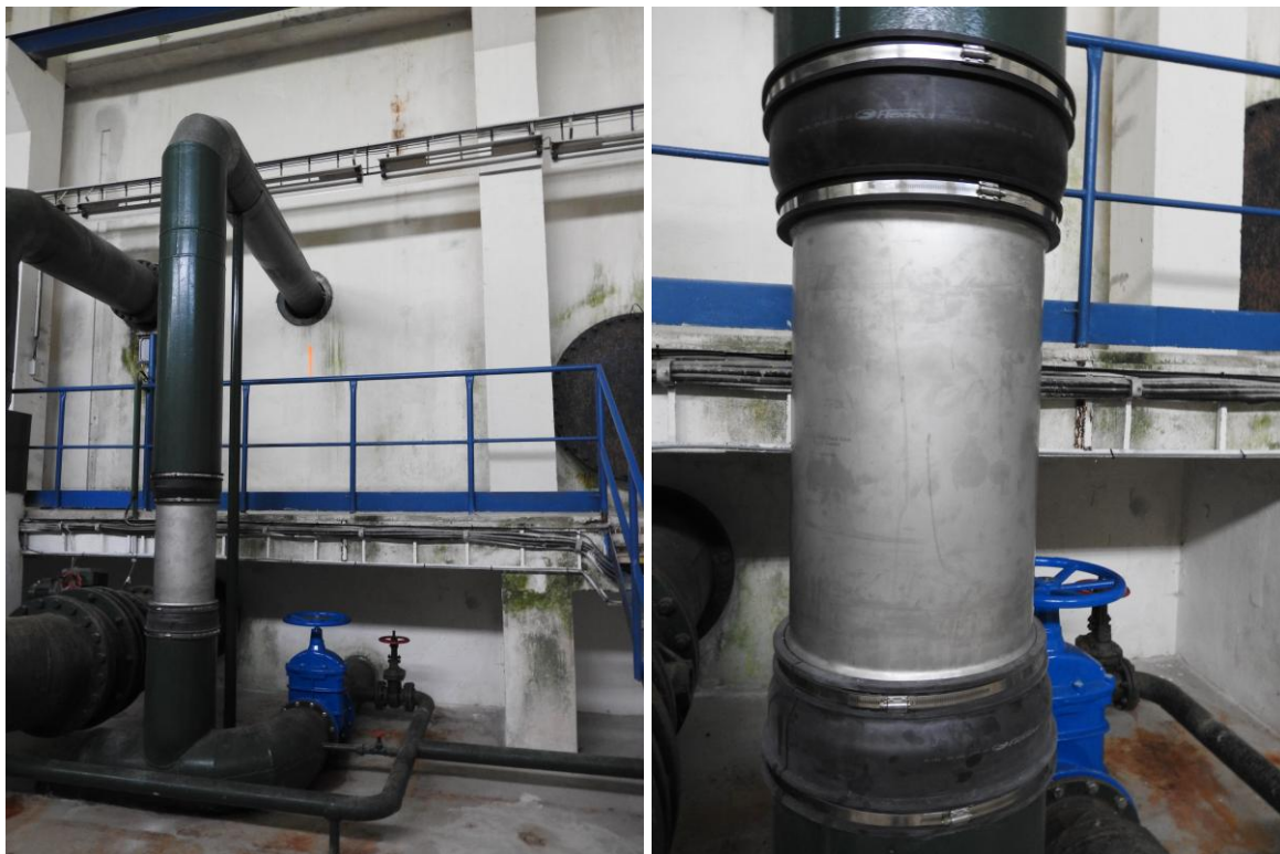
Obrázek 50 Vlevo potrubí bezpečnostního přelivu z AN č.2, vpravo protizápachová a protizáplavová zpětná klapka
