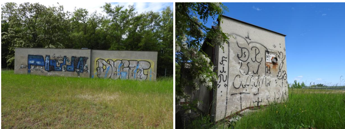
Obrázek 67 Vlevo graffiti zezadu akumulční komory, vpravo graffiti z pravé strany akumulční komory
