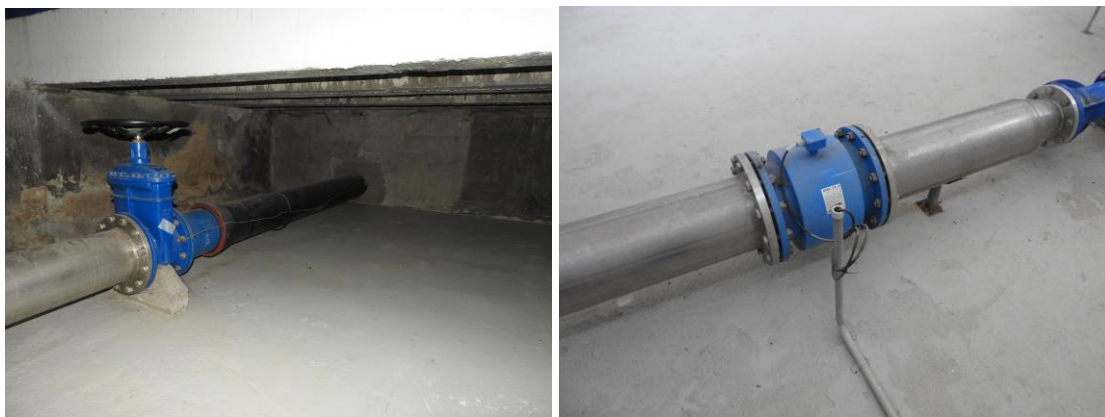
Obrázek 37 Vlevo přívodní potrubí DN 250, vpravo indukční průtokoměr DN 250
