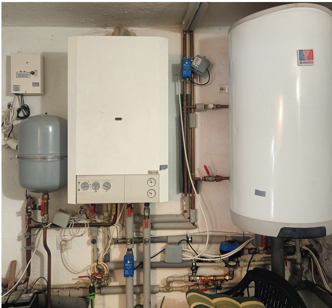
Obrázek 6.6: Pohled na plynový kotel a bojler s elektronickými ventily v technické místnosti
