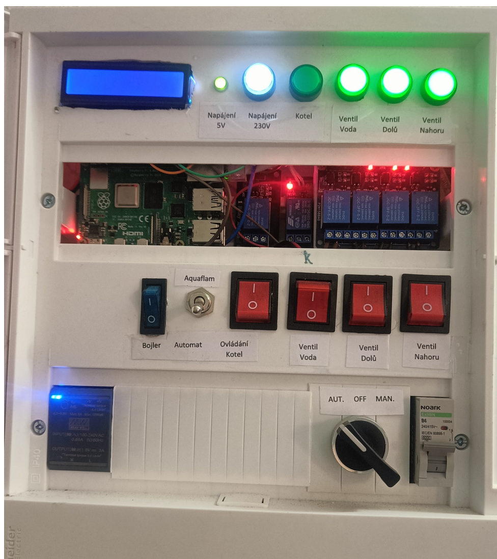
Obrázek A.1: Pohled na ovládání rozvaděče v provozu.
