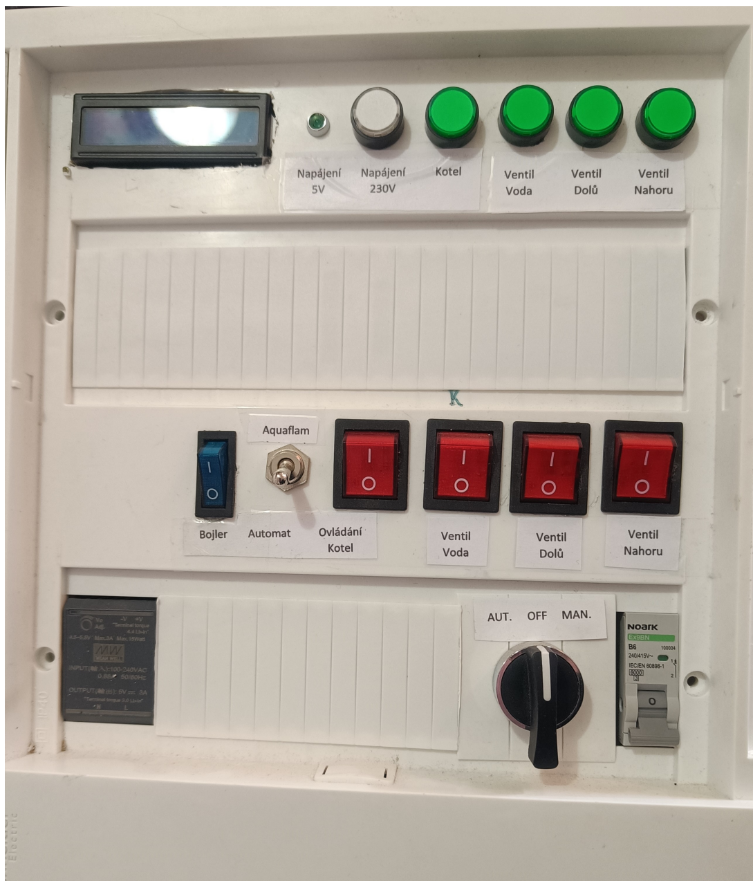
Obrázek A.2: Pohled rozvaděč v zakrytovaném stavu.
