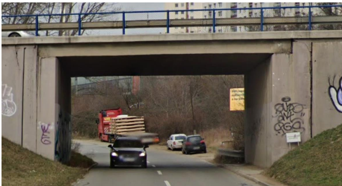
Obrázok 14 - Problematická mostná konštrukcia
