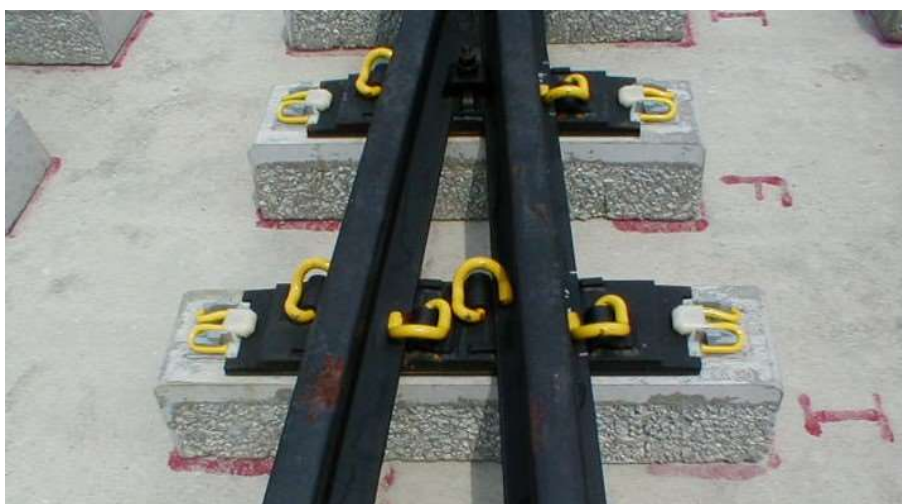
Obr. 46 Systém Pandrol DFC se sponami FC i „e“ ve výhybce instalované na PJD. [79]
