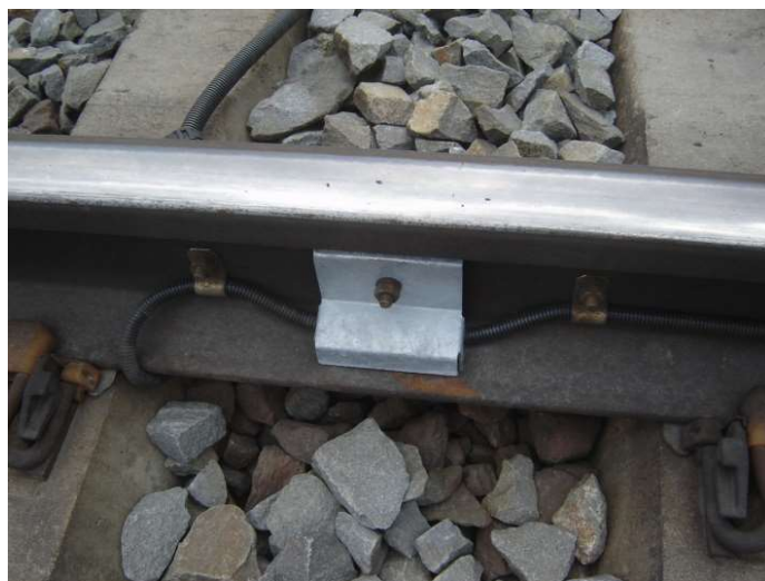
Obr. 73 Snímací část zařízení TON 1 – pohled na kryt snímače v žst. Drahotuše.
