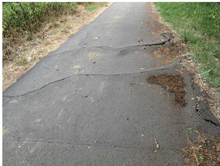
Obr. 2: Důsledky deformace podloží vozovky [3]
