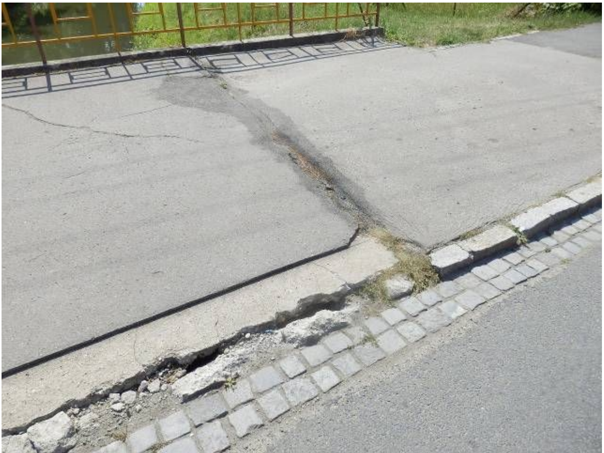
Obr. 42 Pohľad zhora na rozpad obruby a na otvor skrz [20]
