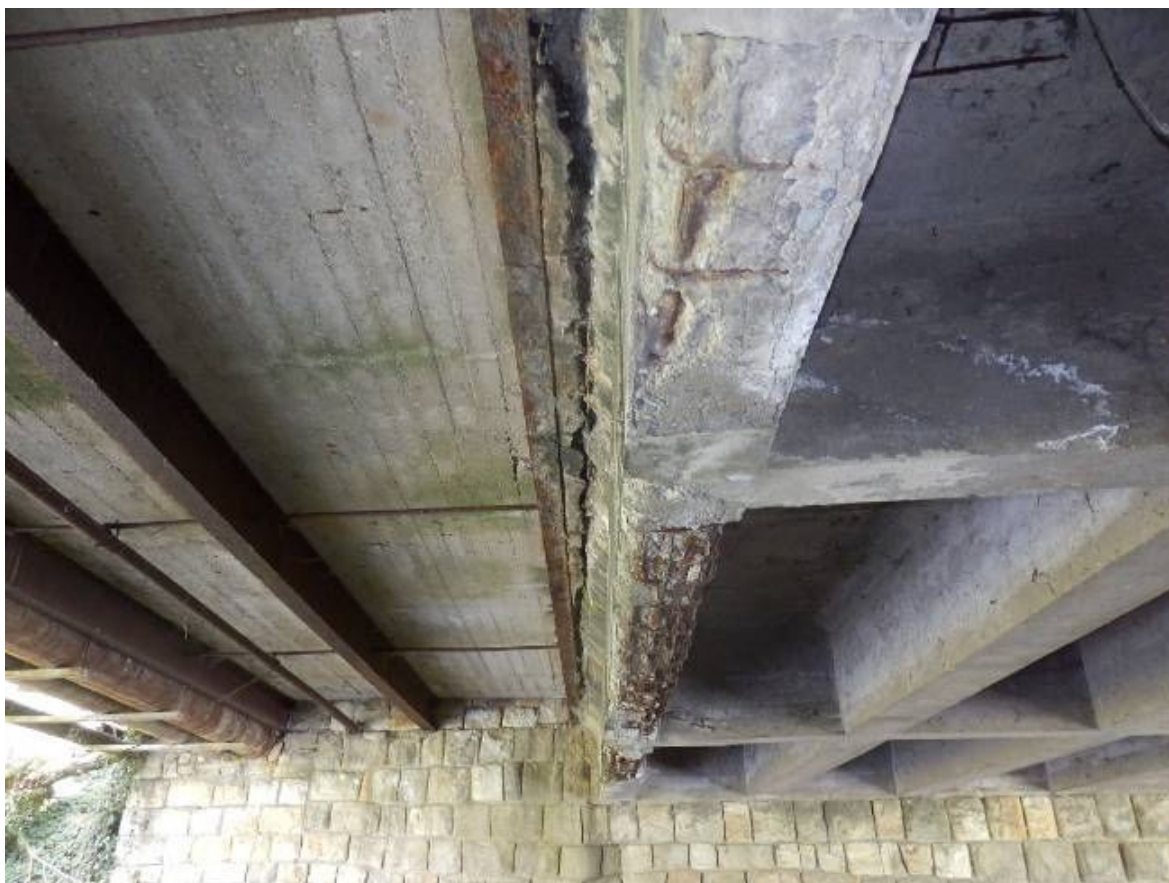
Obr. 44 Pohľad na rozpadajúcu sa rímšu na pravej strane [20]
