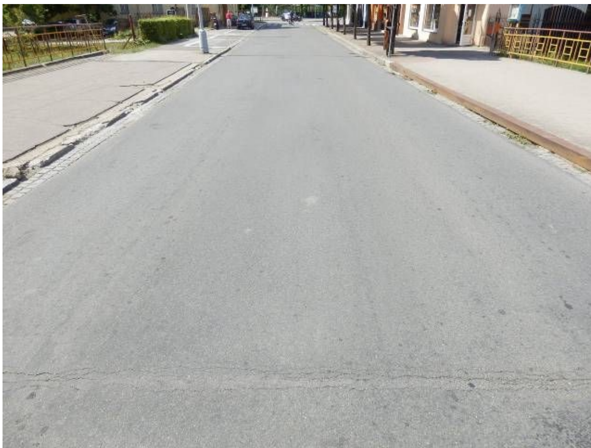
Obr. 40 Pohľad na vozovku a trhliny nad koncom NK [20]
