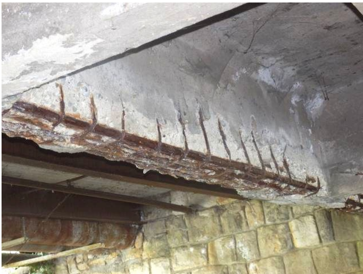
Obr. 32 Poškodený pravý krajný trám v strednej časti NK [20]
