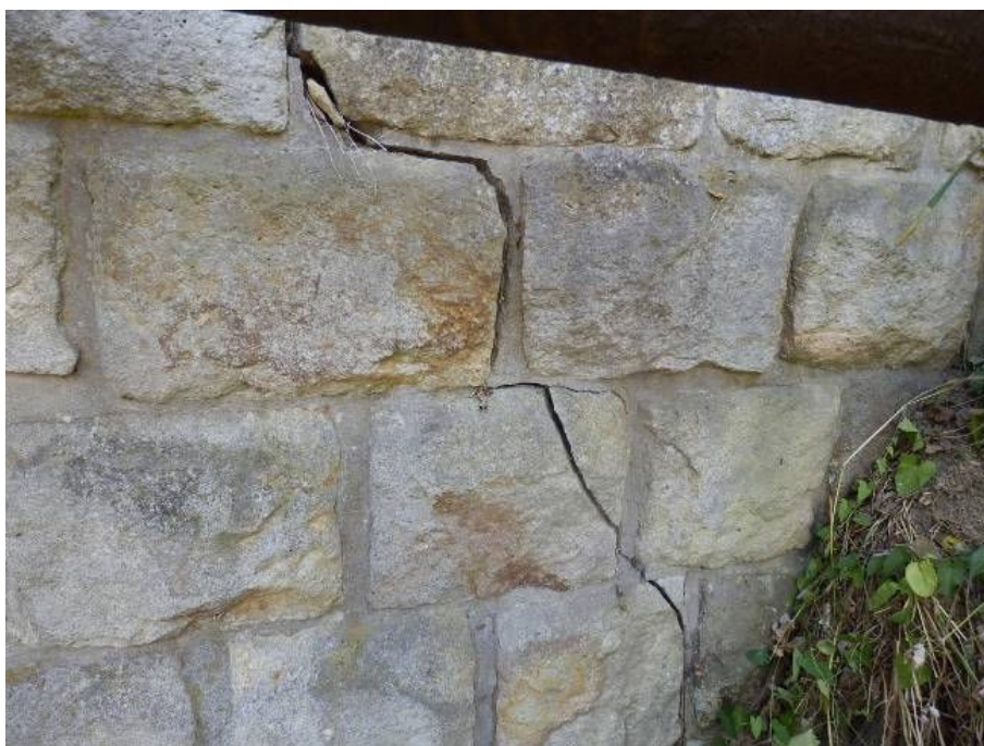
Obr. 30 Detailný pohľad na prasklinu v krídle K2P [20]
