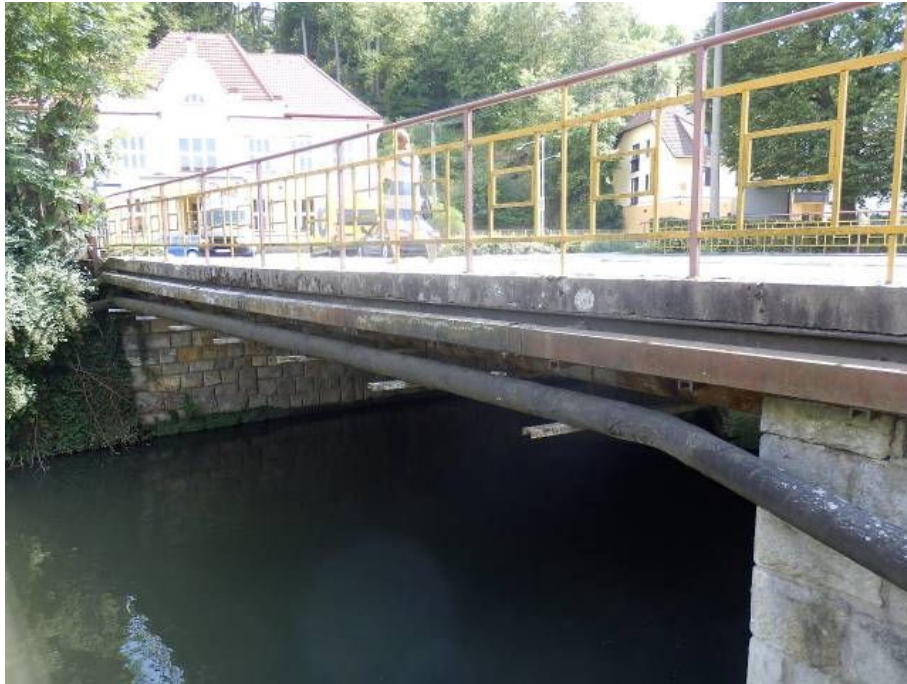
Obr. 52 Pohľad na ocelovú chráničku DN 150 [20]
