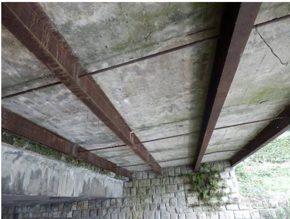
Obr. 37 Korózia ocelových nosníkov a priesaky na mostovke na ľavej strane [20]
