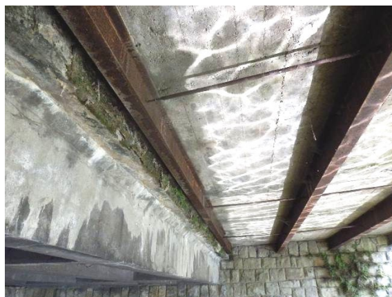
Obr. 39 Poškodenie ocelového trámu vplyvom zatekania na ľavej strane [20]
