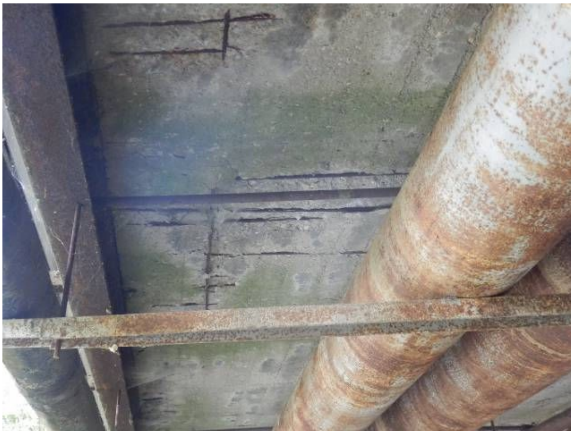
Obr. 36 Priesaky na podhlade a opadnuté krytie výztuže mostovky [20]
