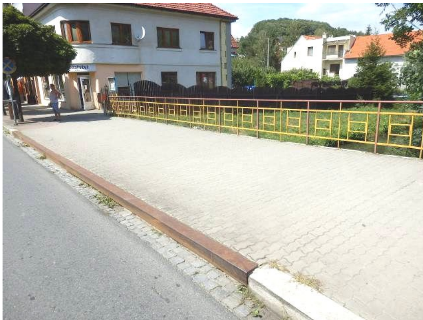
Obr. 48 Pohľad na betonovú zámkovú dlažbu a ocelový obrubník chodníku na pravo [20] Šírka chodníku vlavo (na výtoku) je cca 4,60 m, kryt je z liateho asfaltu, ktorý trpí priečnymi trhlinami po celej dĺžke chodníku. Pozdĺž obruby je liaty asfalt rozpadnutý a v oblasti predmostia je prosedlý až o 0,10 m.
