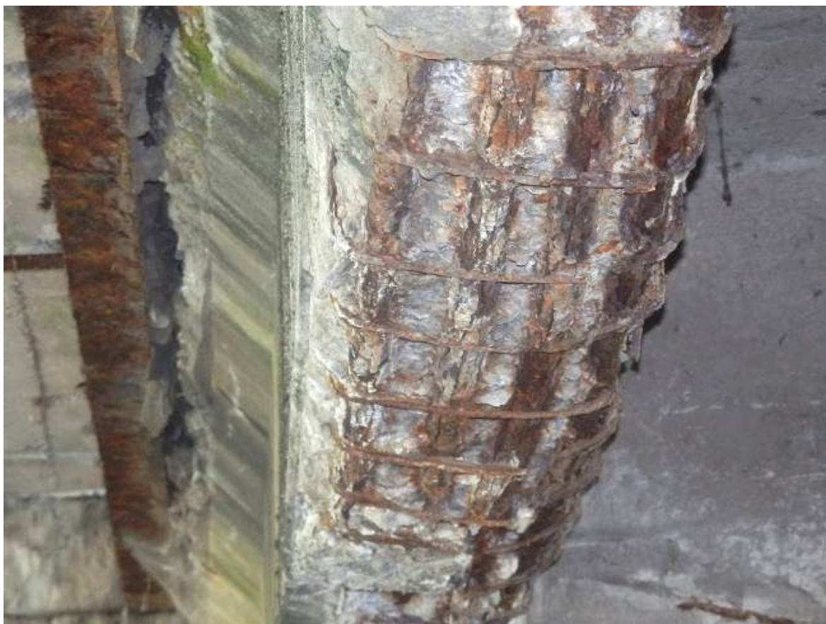
Obr. 33 Detail na rozpad spodnej strany trámu a zoslabenie výstuže [20]
