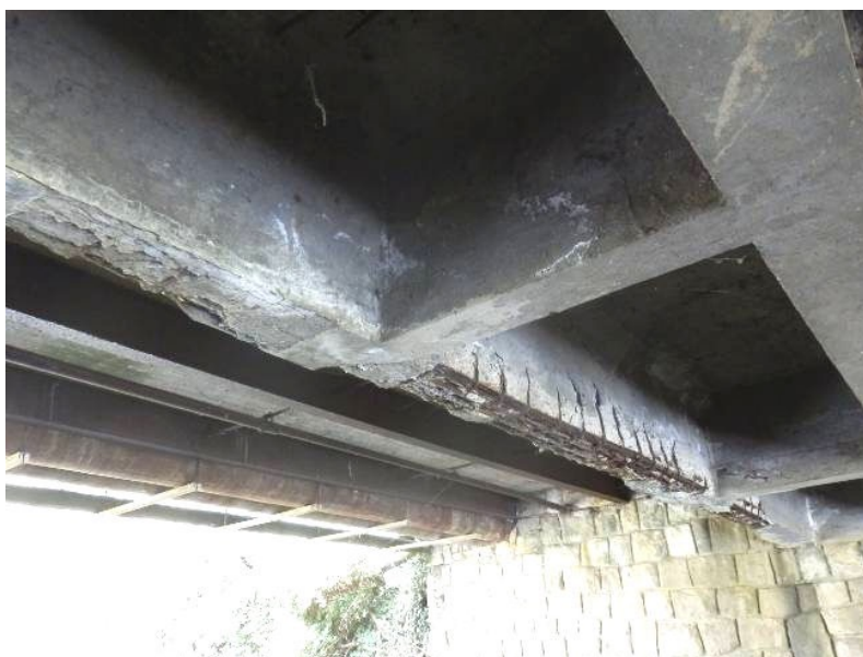
Obr. 31 Poškodenie krajného pravého trávu [20]
