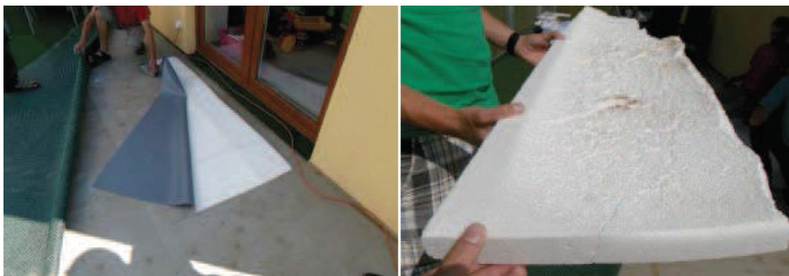
Obrázek 1.2 - Poškozený EPS – Rodinný dům [1]
