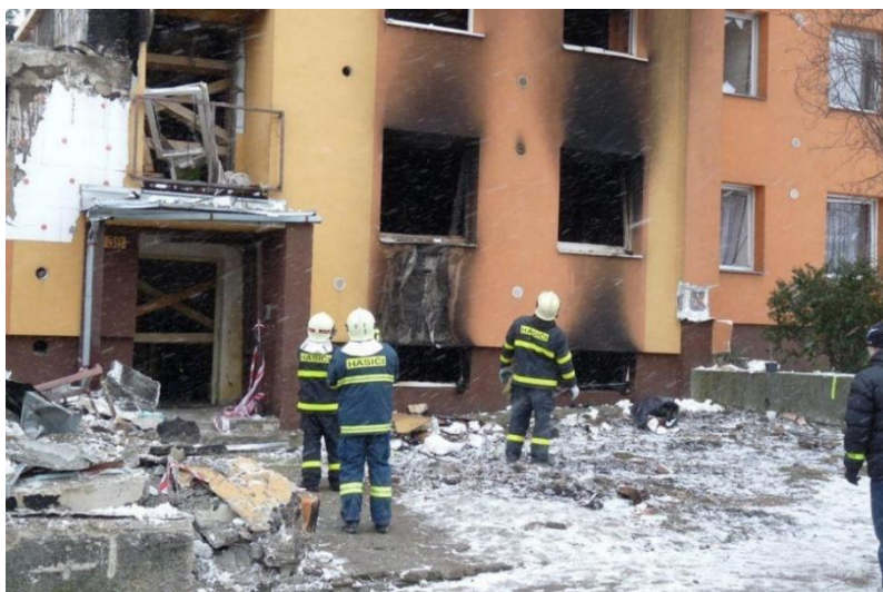
Obrázek 2.3 - Dům ve Frenštátě pod Radhoštěm po požáru [15]
