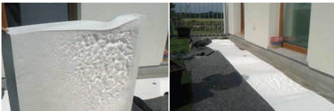
Obrázek 1.1 - Poškozený EPS – Rodinný dům v Lázních Bohdaneč [1]
