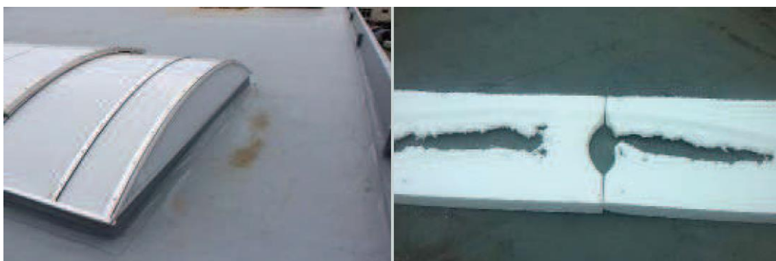
Obrázek 1.3 - Poškozený EPS – Hala v Moravských Budějovicích [1]
