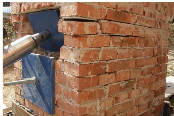
Obr. 7.58 Vodorovná trhlin v pilíři od ohybového momentu v patě klenby
