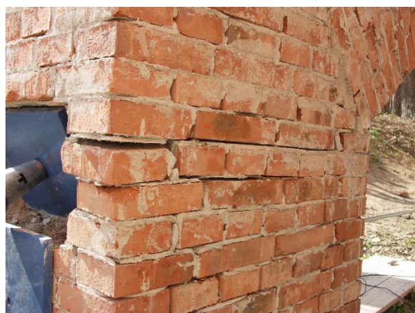
Obr. 7.46 Vodorovná trhlina v pilíři posuvné paty klenby při napínání
