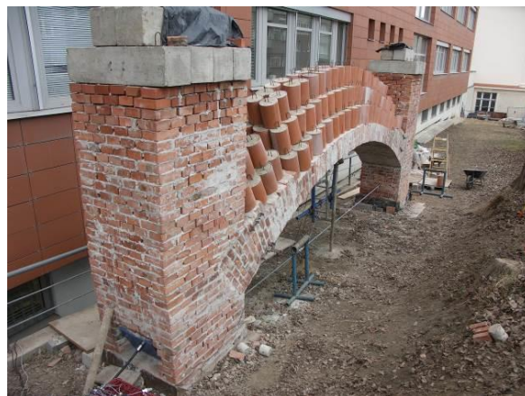
Obr. 7.32 Klenba s plným zatížením 38,409 kN
