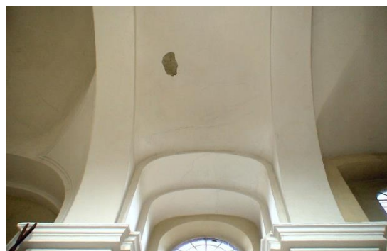
Obr. 8.7 Opadající omítka na kopuli mezi klenbovými pásy č. 2 a 3
