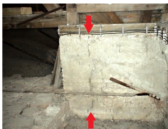
Obr. 8.9 Svislé utržení obvodového zdiva v úrovni střechy, trhlina ve zdivu a volné kované táhlo
