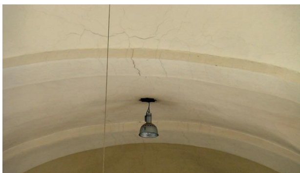
Obr. 8.6 Trhliny ve vrcholu klenbového pásu č. 2
