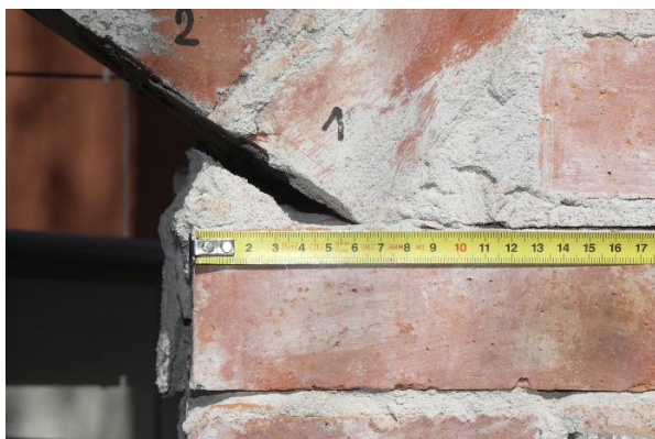
Obr. 7.57 Usmýknutí zdiva ve vodorovné spáře v pilíři
