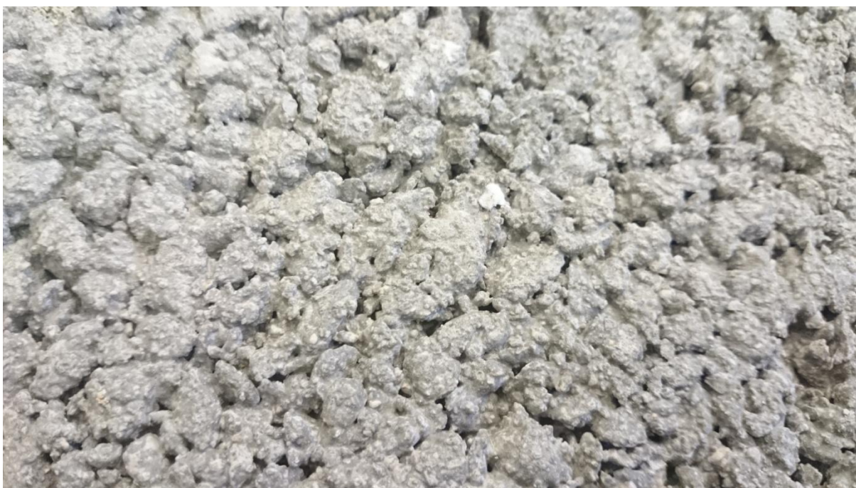
Obr. 5.2 Povrch vodopropustného betonu
