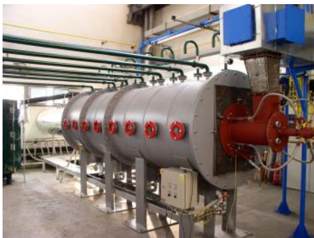
Obr. 13. Zkušebna hořáků ÚPEI. V pravém horním rohu je patrný přívod spalovacího vzduchu [1].
