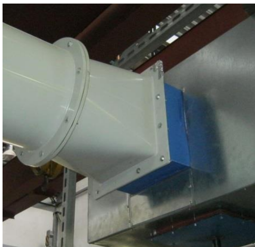
Obr. 15. Napojení potrubní trasy na přívod spalovacího vzduchu.
