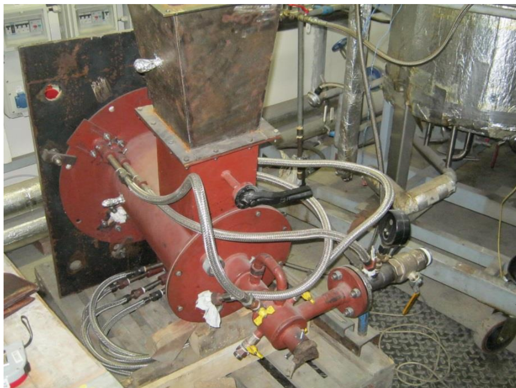
Obr. 7. Celkový pohled na demontovaný low – NO x hořák laboratoře ÚPEI.
