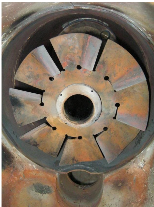
Obr. 6. Pohled do těla hořáku na primární trysku zemního plynu s nasazeným vířičem spalovacího vzduchu. Spodní otvor slouží ke vložení pilota.
