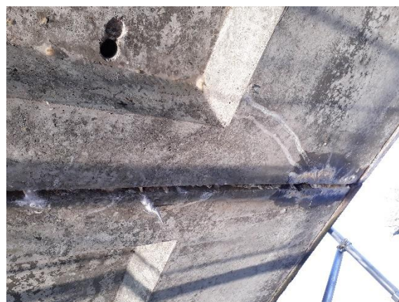
Obr. 6.4 Stav spáry mezi segmenty 9 a 10 v roce 2019 po diagnostice – povodní strana
