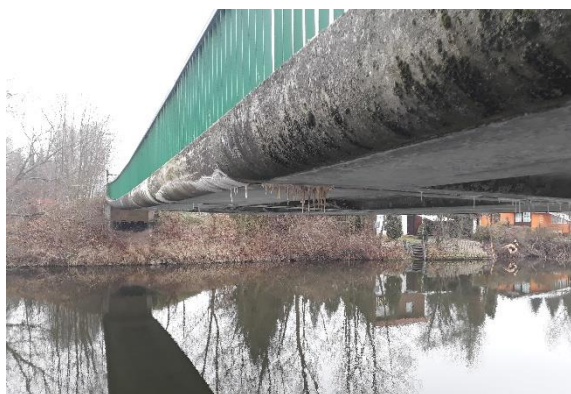
Obr. 6.1 Stav spáry mezi segmenty 9 a 10 v roce 2019 před diagnostikou – návodní strana
