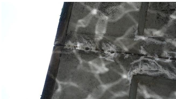
Obr. 6.9 Stav spáry mezi segmenty 9 a 10 v roce 2024 při hlavní prohlídce [39] – návodní strana
