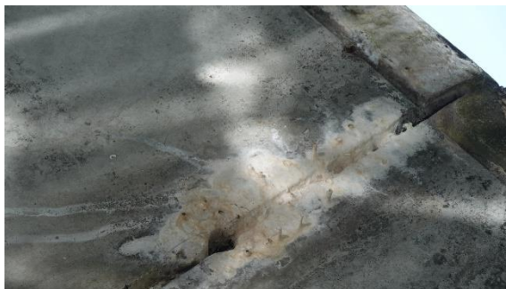
Obr. 6.10 Stav spáry mezi segmenty 9 a 10 v roce 2024 při hlavní prohlídce [39] – povodní strana
