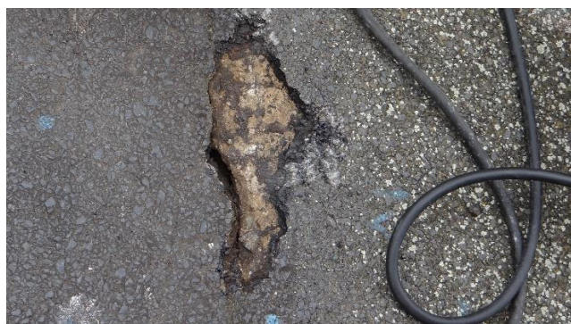
Obr. 4.31 Poškozený kryt mostovky – místo zatékání do nosné konstrukce
