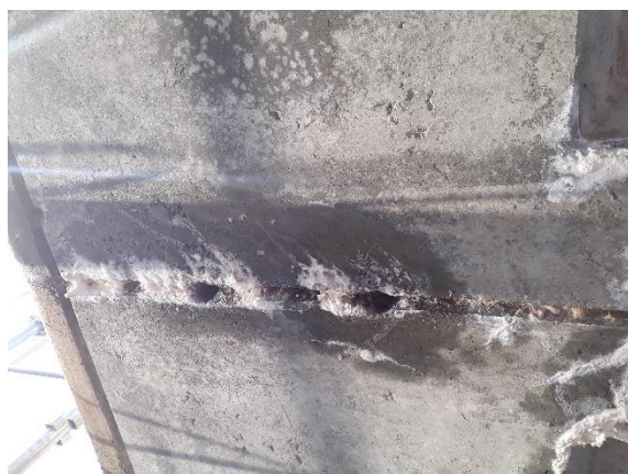
Obr. 6.3 Stav spáry mezi segmenty 9 a 10 v roce 2019 po diagnostice – návodní strana
