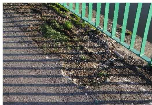
Obr. 4.32 Vegetace v krytu – projev zatékání
