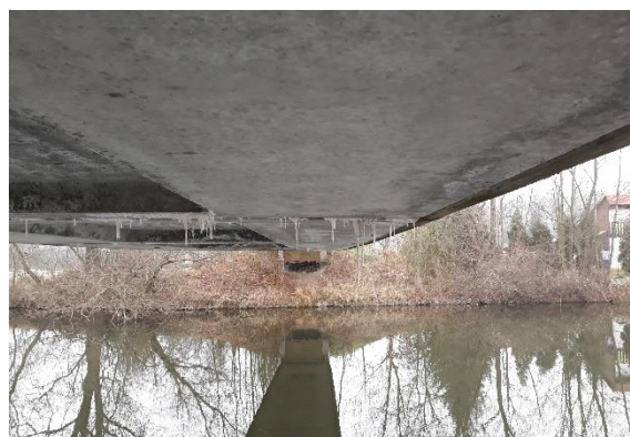
Obr. 6.2 Stav spáry mezi segmenty 9 a 10 v roce 2019 před diagnostikou – povodní strana
