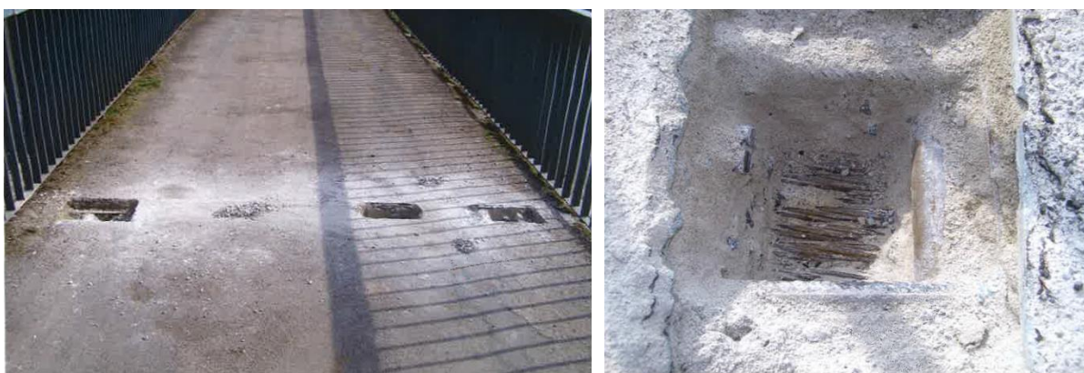
Obr. 4.33 Neodborně provedená diagnostika lávky přes řeku Ohři v Radonicích nad Ohří [58]
