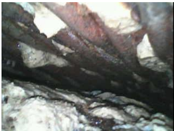
Obr. 4.11 Neobetonované nosné kabely (betonová směs se neprotlačila přes kabely v době výstavby)
