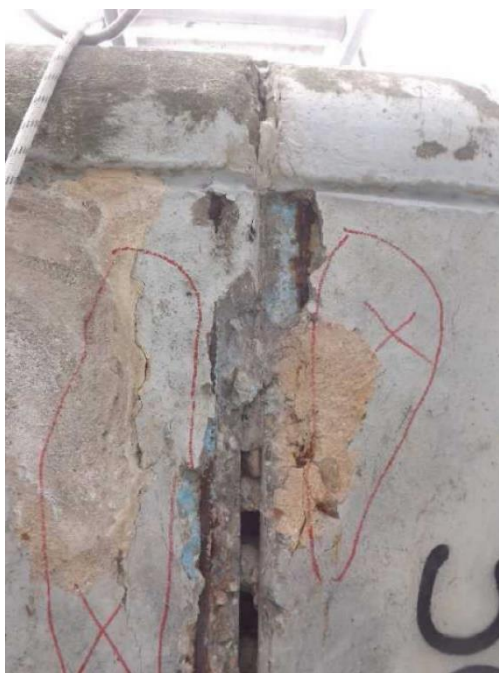
Obr. 4.26 Spodní povrch návodní strany spáry mezi segmenty 37 a 38 [35]
