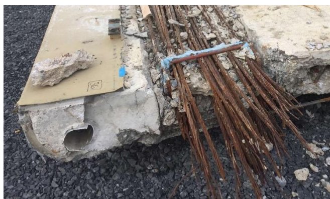
Obr. 4.27 Pohled na segment 36 od segmentu 35 po havárii lávky – pravděpodobné místo přetržení lan [60]
