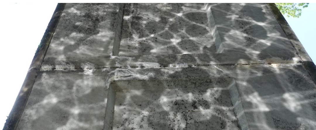
Obr. 6.8 Stav spáry mezi segmenty 9 a 10 v roce 2024 při hlavní prohlídce [39]
