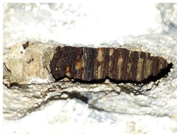
Obr. 4.20 Stav nosných lan ve spáře na návodní straně mezi segmenty č. 9 a 10 (číslováno od OP1)
